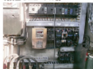
制御盤 リニューアル前
