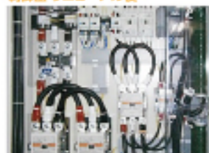
制御盤 リニューアル後
