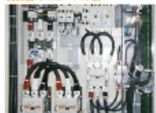
制御盤 リニューアル後
