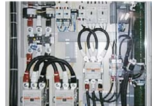
制御盤 リニューアル後
