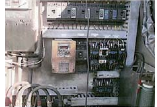
制御盤 リニューアル前
